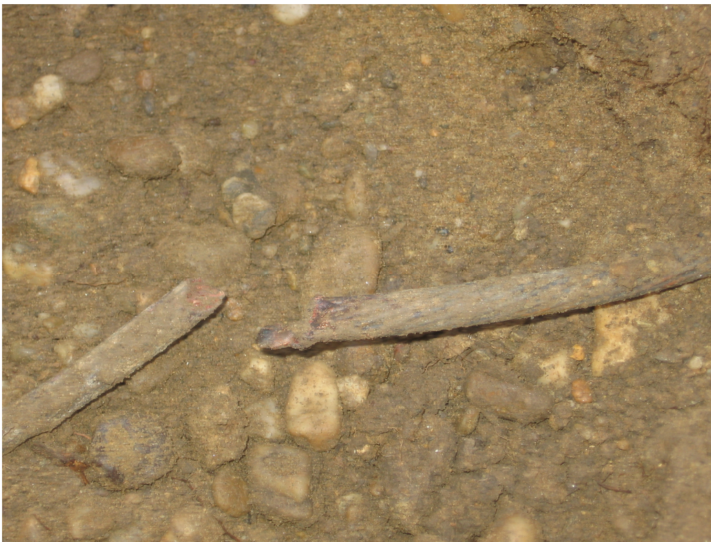
Slika 40 Prikaz oštećenog provodnika mrežastog uzemljivača
