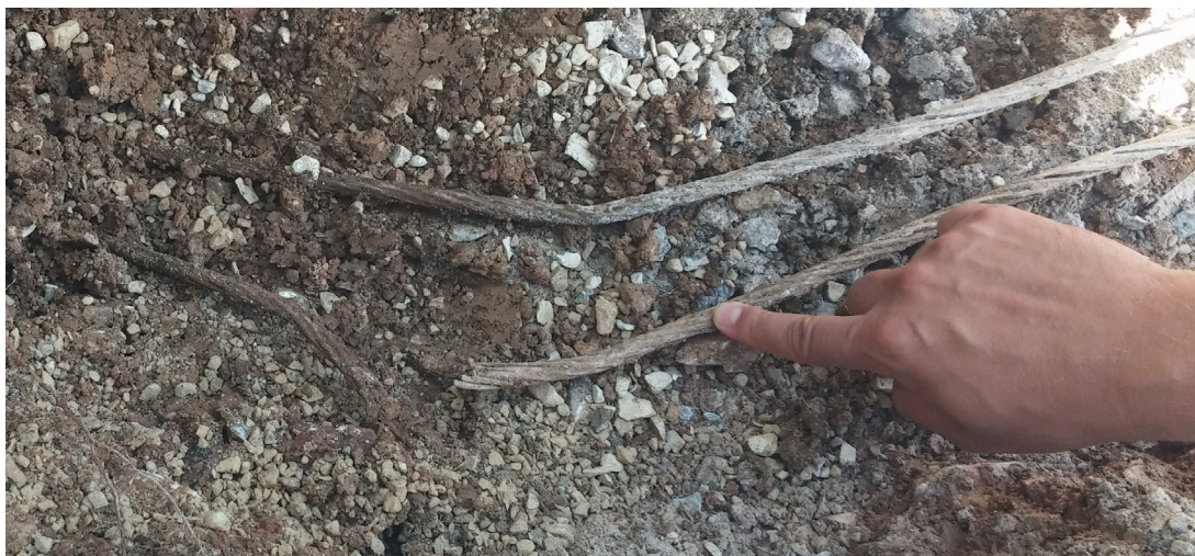
Slika 37 Prikaz oštećenog zemljovoda (pozicija #59)
