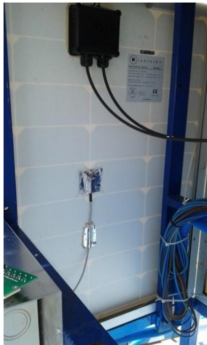
Slika 3.5. Pt 100 temperaturne sonde postavljene na sredini zadnje strane solarnog modula
