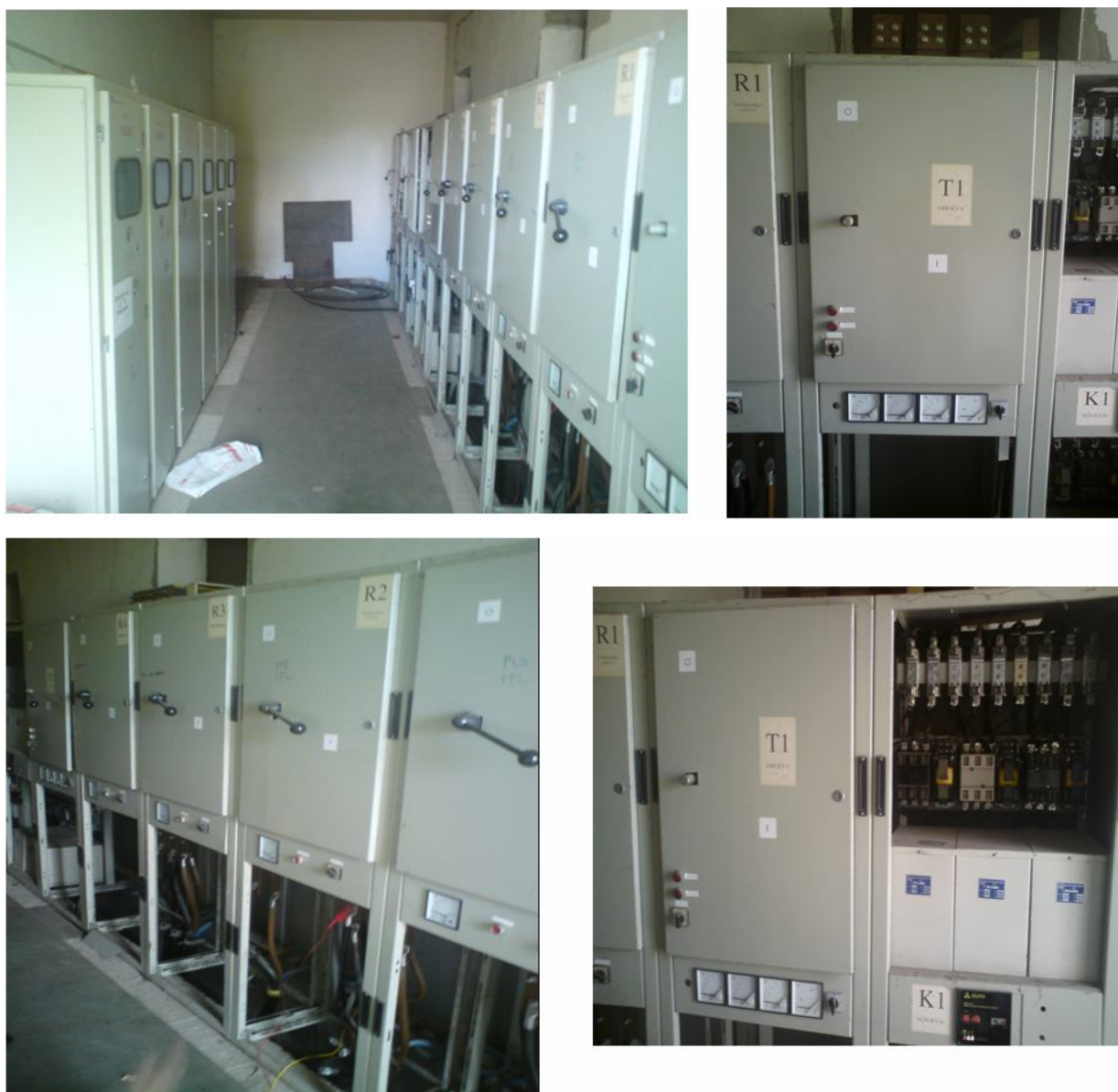
Slika 6.33. Ilustracija radnog okruženja u transformatorskoj stanici TS 10/0.4kV
