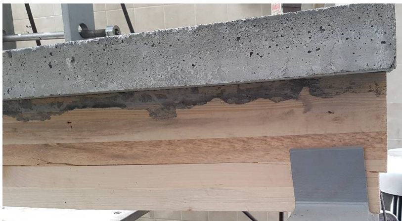
Slika 6.5.1.7 Smičući lom drvenog dela spregnutog nosača BF-3 u zoni oslonca
