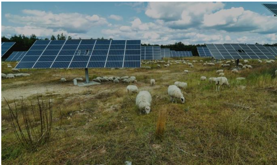
Slika 30. Instalirani sistem solarne energije u Feldhajmu (Energiequelle, 2014)
