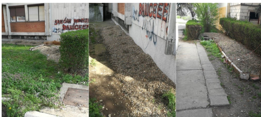
Slika 1 Improvizovano rešenje stanara izabranog stambenog područja za zaštitu podrumskih prostorija od plavljenja
