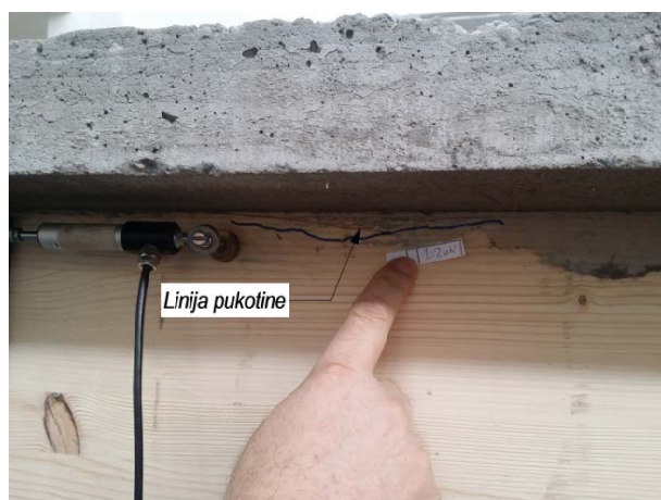
Slika 5.4.4.4 Pukotina u gornjoj zoni drvenog dela nosača
