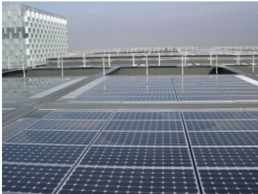
Сл. 5.1.27 Детаљ крова зграде Telefonica C District, Мадрид, Шпанија (Извор фотографије: www.pvdatabase.org/projects_view_details.php?ID=298 )
